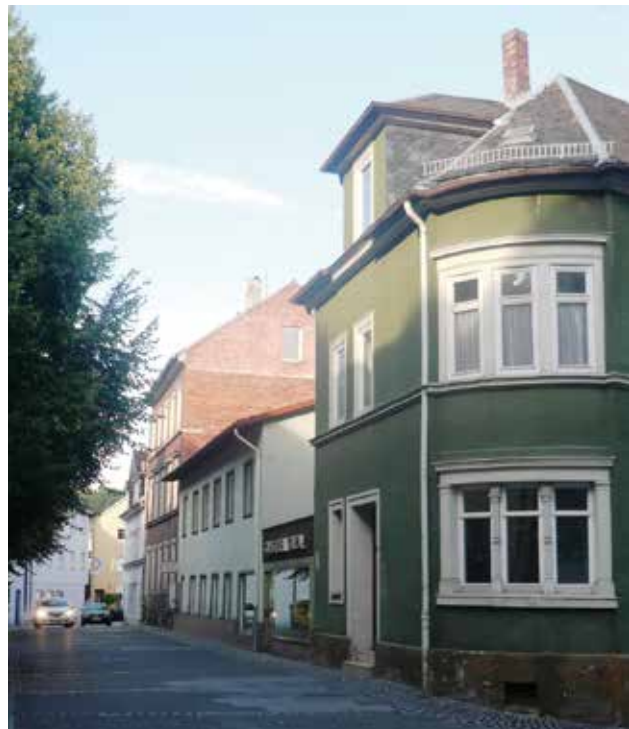
Für den Gebäudekomplex in der Walkmühlgasse stehen Sanierungsmaßnahmen noch aus.
